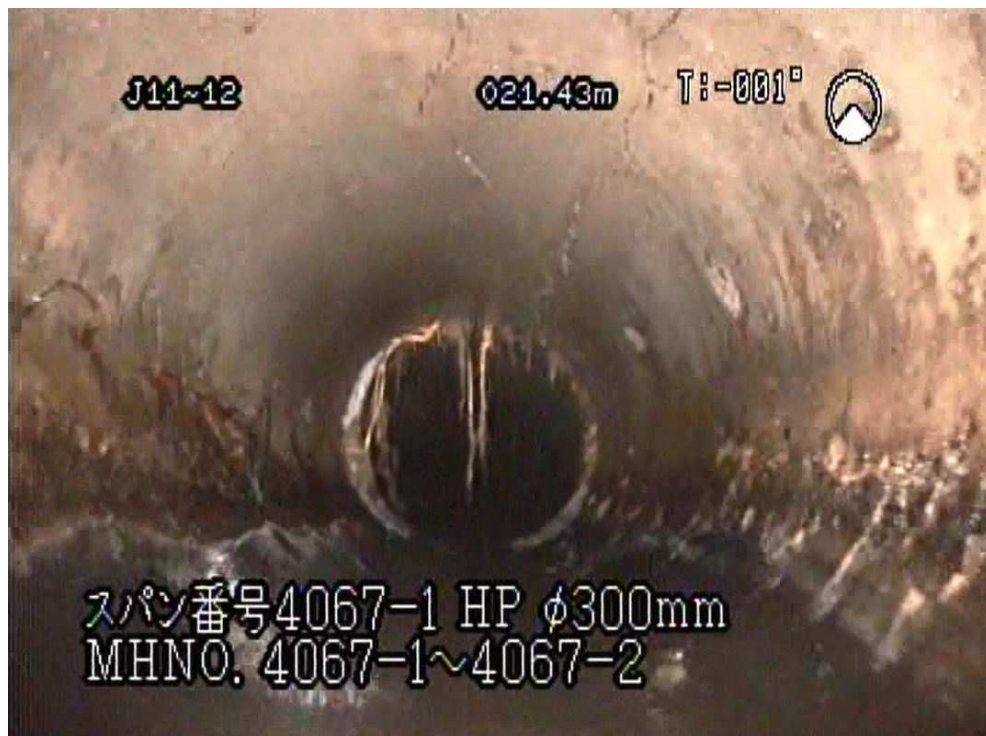
管渠のひび割れ
